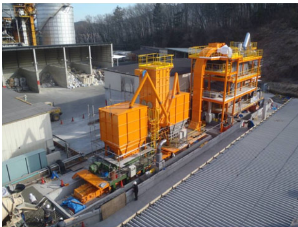
写真3 廃棄物・副産物の受入れ設備
