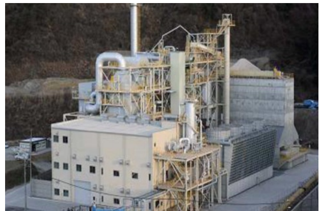
写真5 バイオマス発電設備
