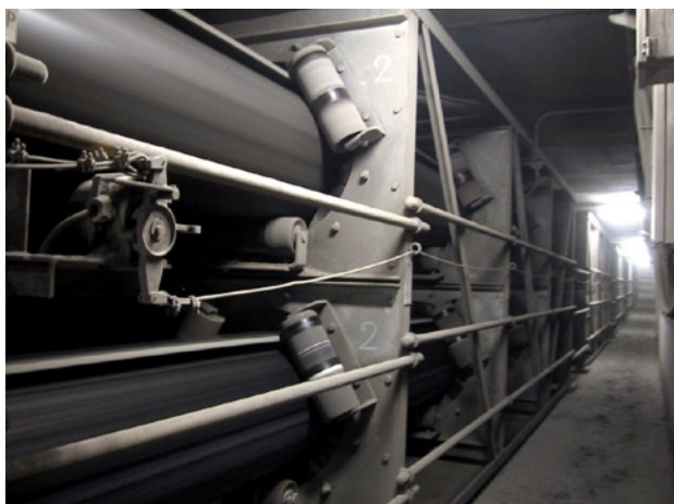
写真3 工場と港を結ぶ輸送設備・MACH幹線BC (ベルトコンベア)
