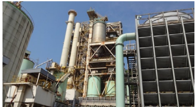
写真7 売電向け自家発電設備3号発電所
