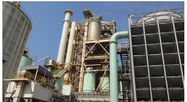
写真7 売電向け自家発電設備3号発電所
