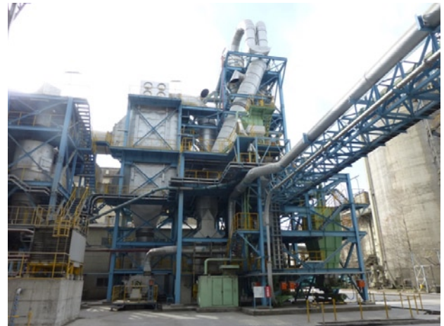
写真3 下水汚泥乾燥設備
