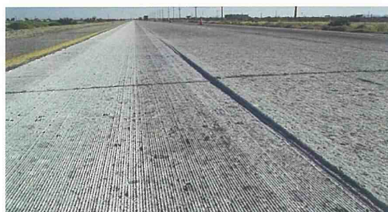
写真4 ダイヤモンドグラインディングによって縦方向に溝が切られたコンクリート舗装の路面
