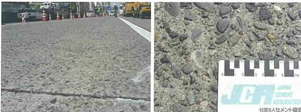
写真1 コンクリート舗装の路面状況
