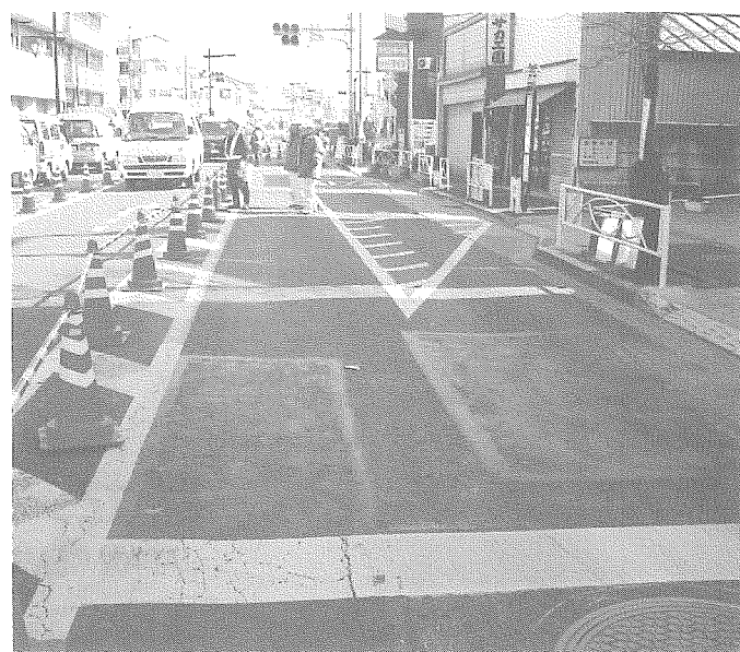
▲写真1 施工前の状況 アスファルト舗装にパッチングなど補修をしてもすぐにわだち掘れが生じてしまう。そこで今回、ホワイトトッピング工法で修繕を試みた。
