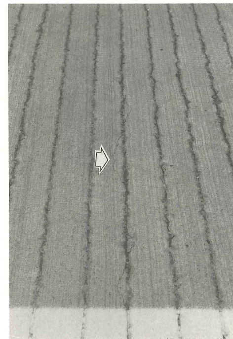
Q10・写真1 0.5mm以下の横ひび割れの例
