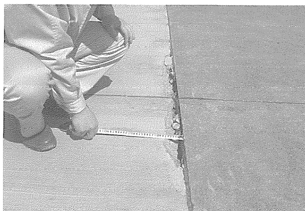
写真7 段差発生個所の角欠け(除雪被害)
