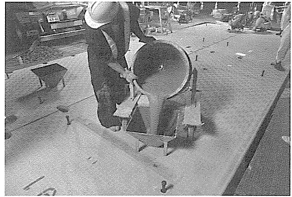
PRC版設置が終了すると続いてグラウト充填が行われる。
