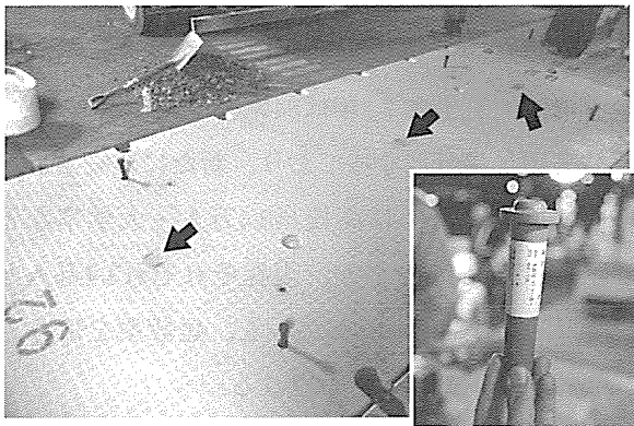
水道用のものを転用した空洞確認用の埋設マーカー。矢印部に挿入される。
