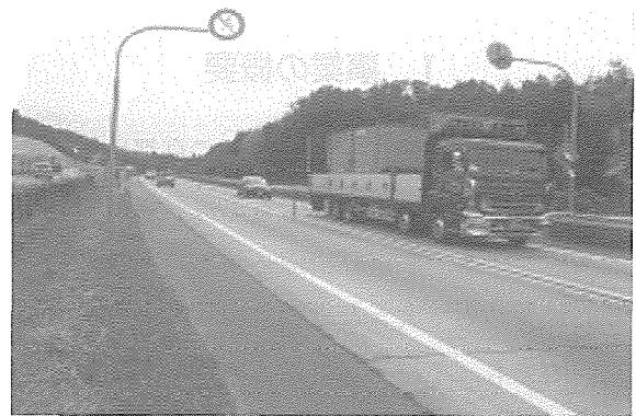
写真2 東山IC付近のコンクリート舗装, 健全な舗装状況(23年経過)
