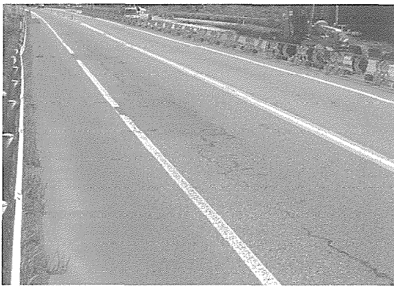
写真1 ニッ梨付近のアスファルト舗装の状況 (21年経過), パッチング・ひび割れ補修状況
