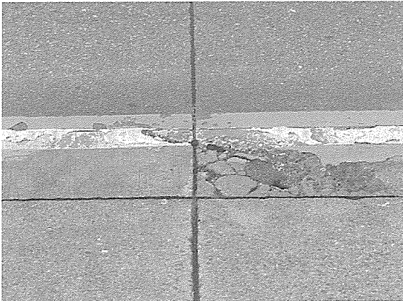
写真3 隅角部のひび割れ
