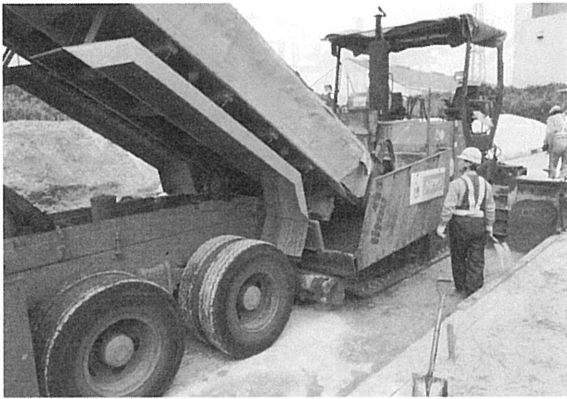
写真1 RCCPゼロスランプコンクリートをダンプからフィニッシャーに投入
