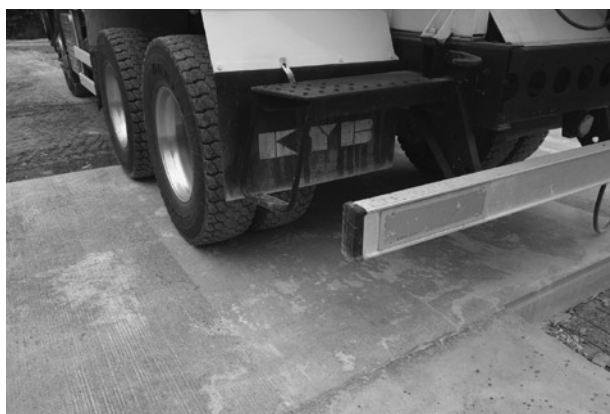
写真2 前日施工のW/C40%、早強配合のエリア、重量車の荷重も問題なく供用
