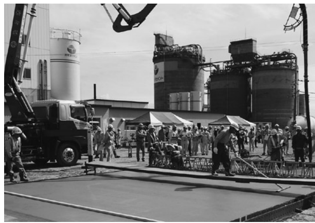
写真6 施工の様子。コンクリートが比較的軟らかく、ほうき目を入れるタイミングが難しいといわれているが、きれいな仕上げがなされた
