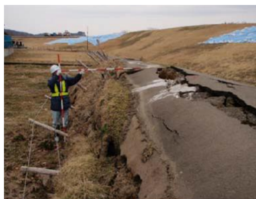
(B) 裏法側道の隆起・はらみ出し
