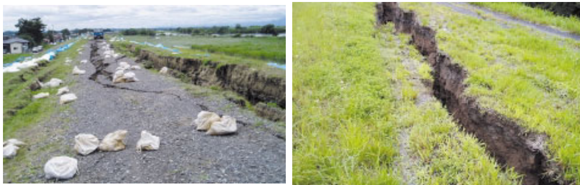
(A) 堤防天端縦断クラック
