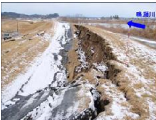
(A) 天端沈下、縦断クラック
