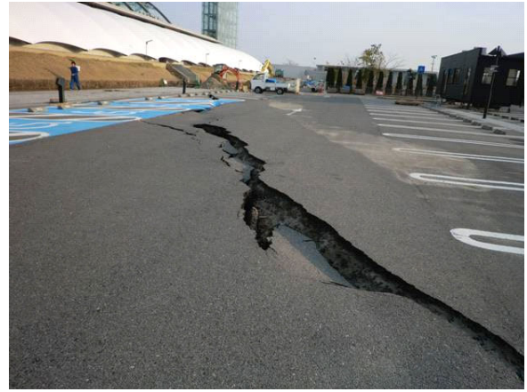
写真 4.3.4 施設周辺の被害状況その 2
