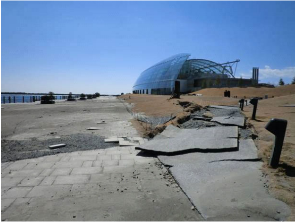
写真 4.3.3 施設周辺の被害状況その 1
