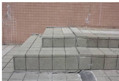
写真③ 屋外階段の不同沈下
