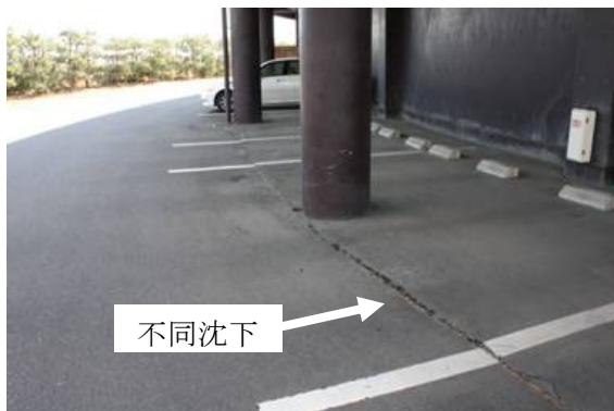
写真④ 駐車場の不同沈下
