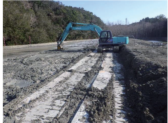
写真 8 BH-RM 処理機 (バックホウタイプ)
