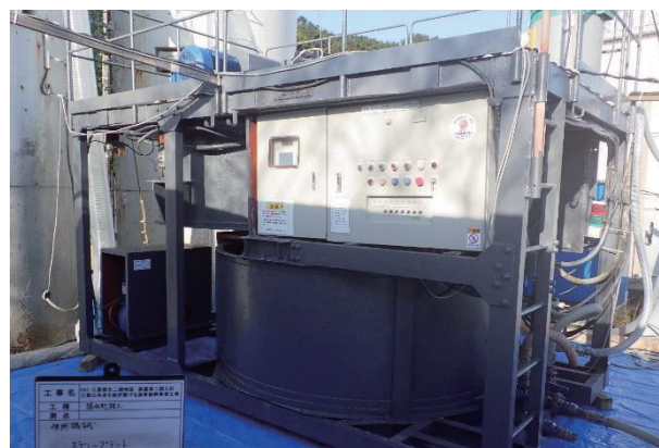
写真 11 スラリープラント (固化材スラリー製造用)
